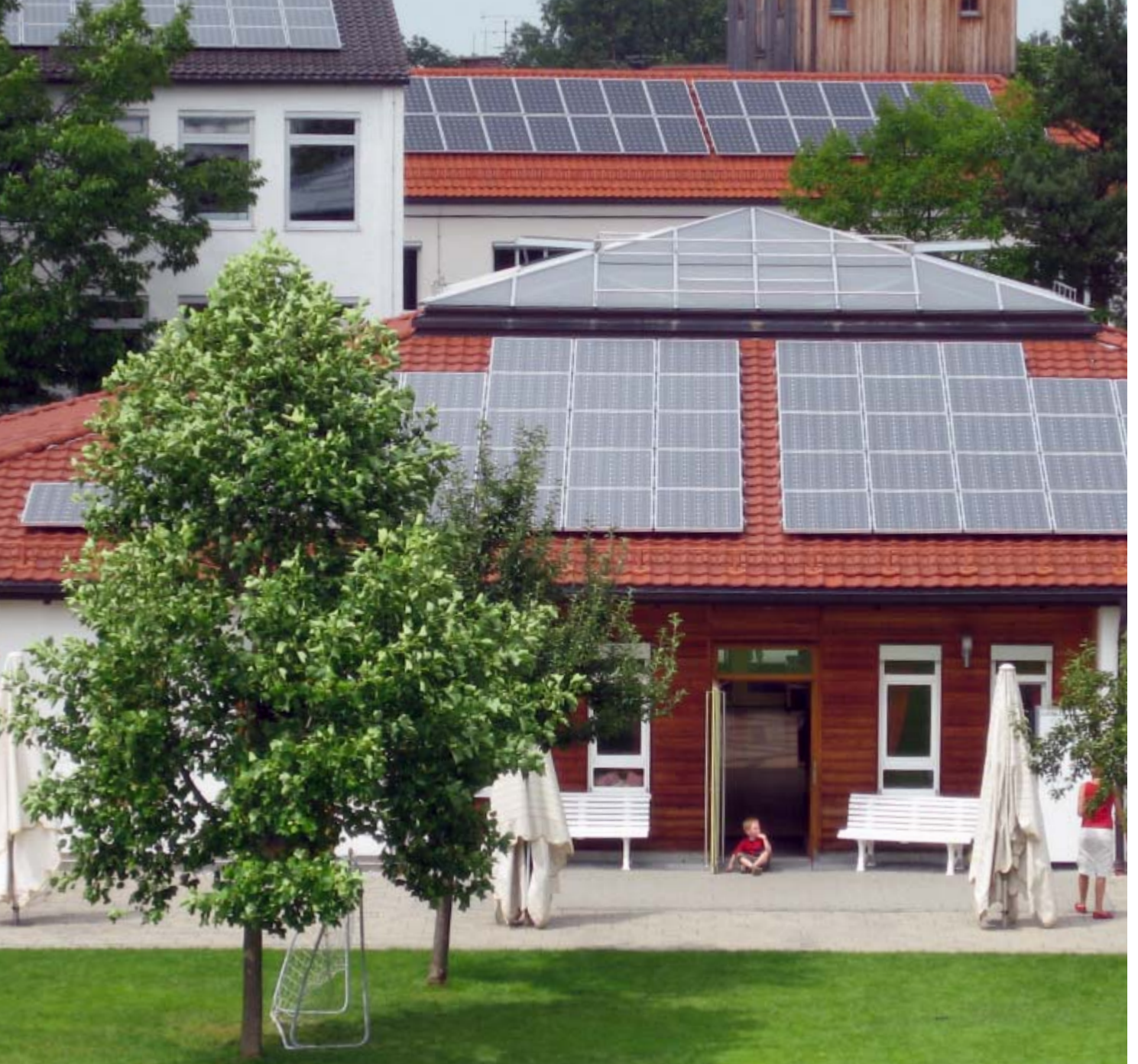
Photovoltaikanlagen der Gemeinde auf den Dächern von Kindergarten, Grundschule und Rathaus
