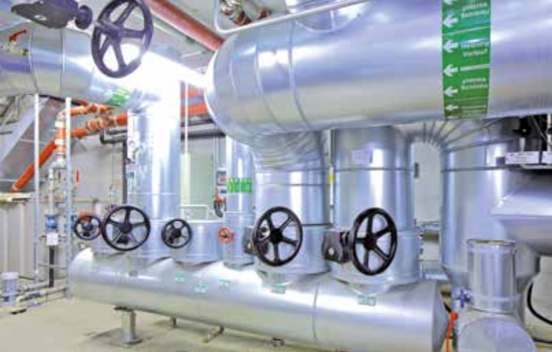
Geothermie Heizwerk, Foto: SWM / Stefan Obermeier
